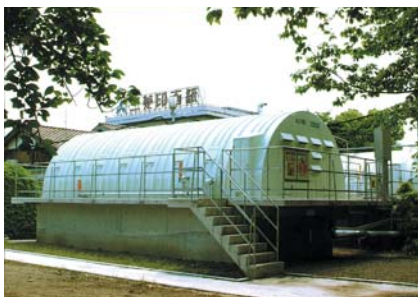
回転円盤式活性汚泥処理装置 3号機
