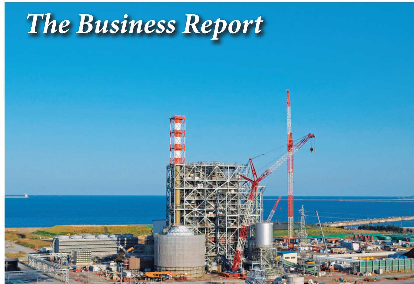
建設中の八戸エコエネルギー発電所（王子グループとの共同バイオマス発電事業／八戸工場）
